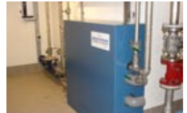
Ultralydsanlæg placeret i støjkasse
