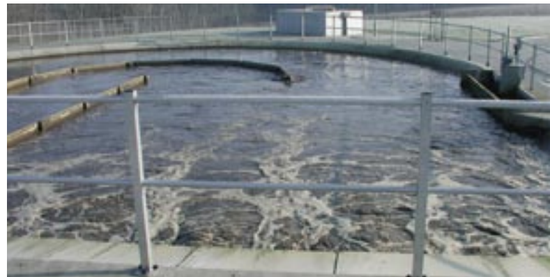
Maxi-rotoren installeret i processtanken giver effektiv beluftning.
